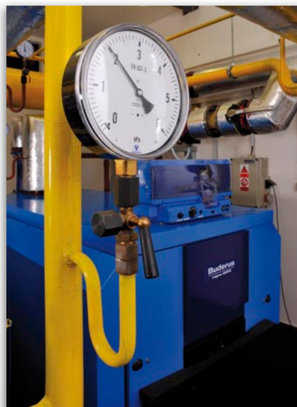
Kotelna Pod Strojírnami
