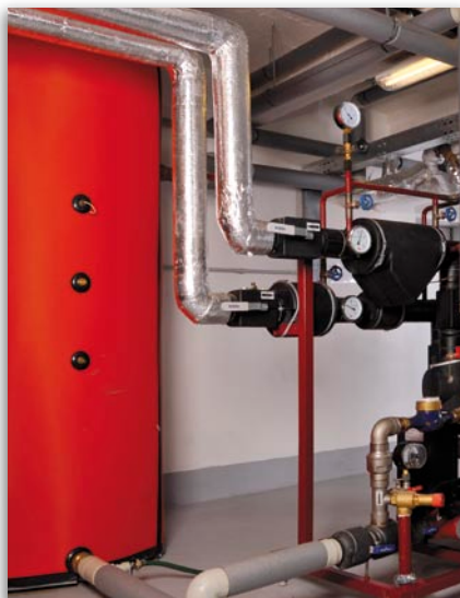
Výměňková stanice Na Vyhlídce
